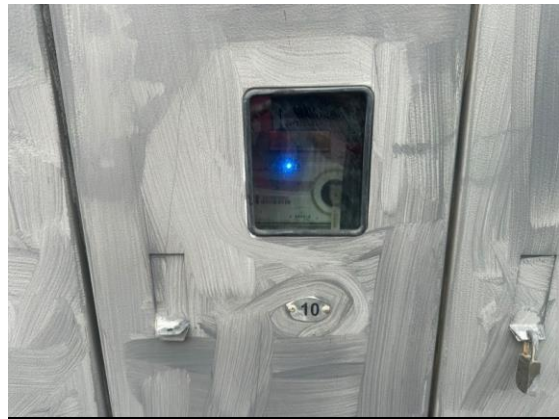
Descrição: Medidor de energia
