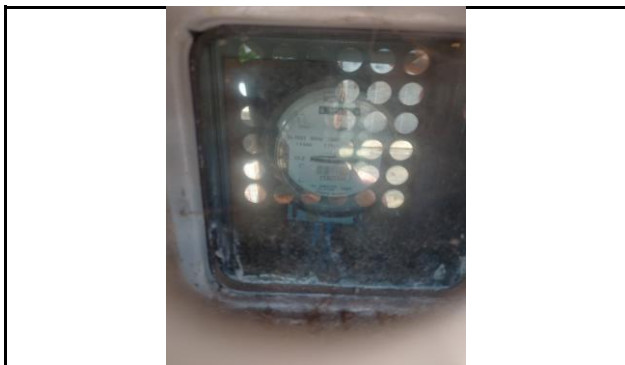
Descrição: Medidor de energia elétrica
