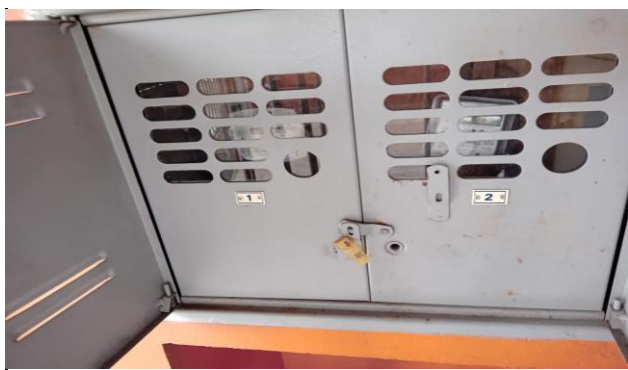
Descrição: Medidor de energia elétrica
