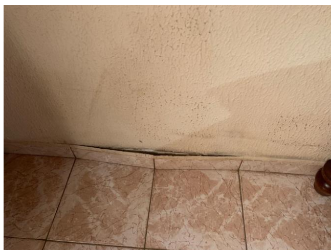
Necessita de alguns reparos
