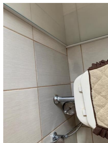
Vazamentos e infiltrações
