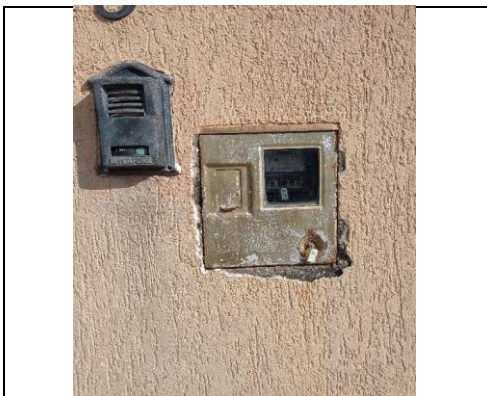
MEDIDOR DE ENERGIA ELÉTRICA
