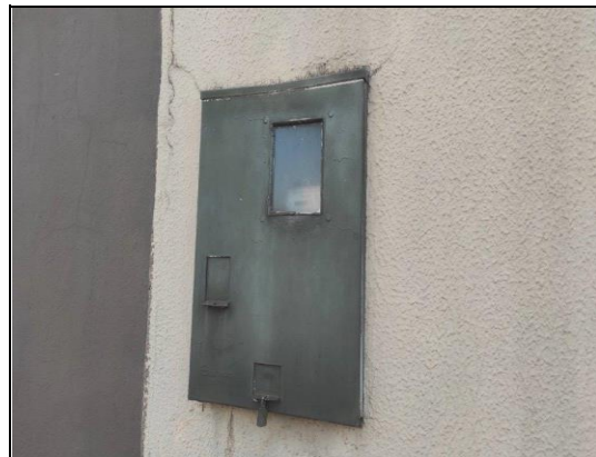
MEDIDOR DE ENERGIA
