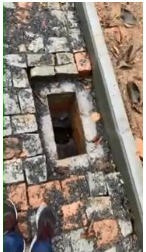
Coletor aguas pluviais
