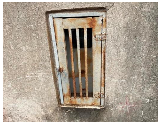
MEDIDOR DE ENERGIA ELÉTRICA
