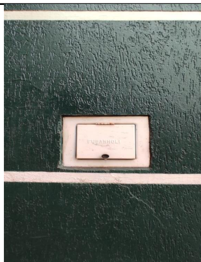
MEDIDOR DE ENERGIA
