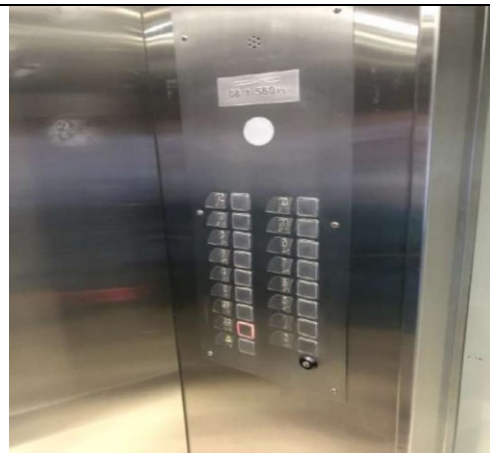
Painel do elevador
