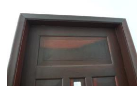
APTO. 303 : ACESSO SOCIAL SEM IDENTIFICAÇÃO
