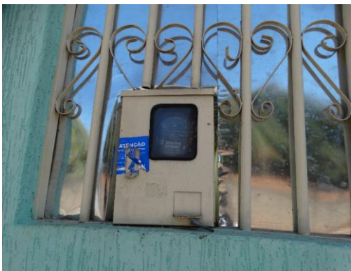
MEDIDOR DE ENERGIA ELÉTRICA
