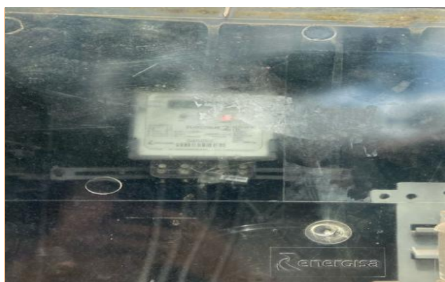
Descrição: Medidor de energia
