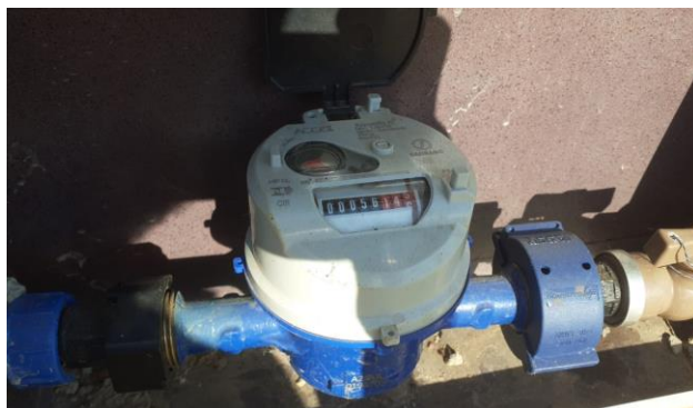
Descrição: MEDIDOR DE ÁGUA
