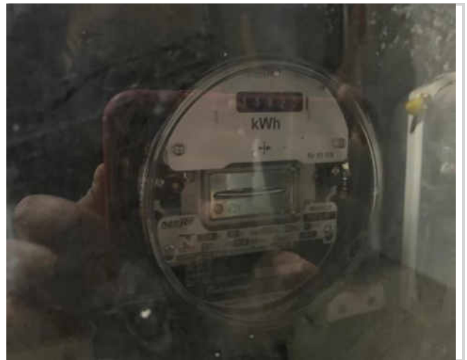
Medidor de energia
