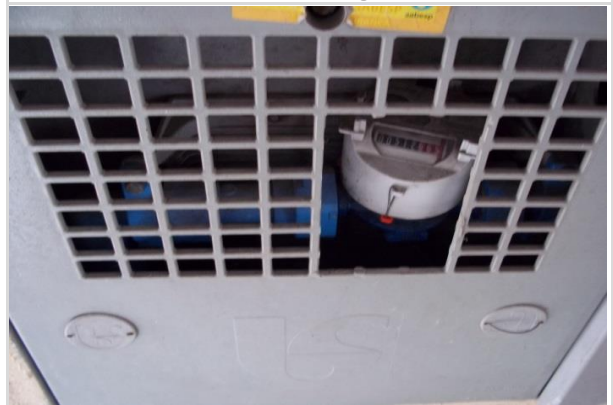
Cavalete de água
