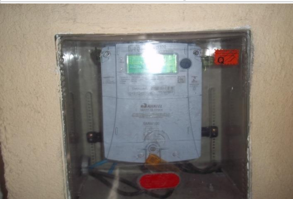
Medidor de energia
