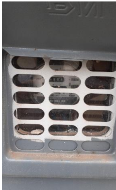
Medidor de energia
