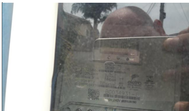
Descrição: Medidor de energia elétrica
